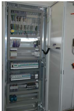
Schaltschrank Wärmeverteilung neu
